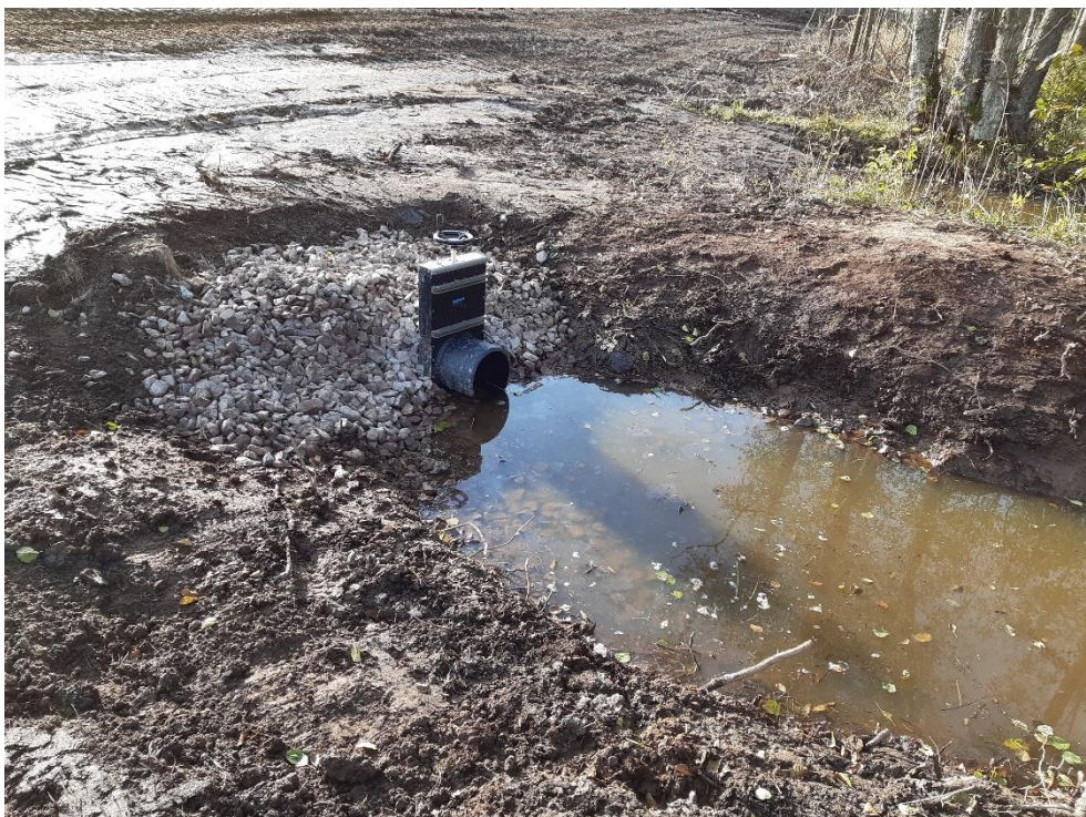
Figur 26. I botten av vallen lades ett tömningsrör. Här har det på insidan av våtmarken försetts med en WaGate – en sluss - som möjliggör tömning av våtmarken. Vilket kan vara nödvändigt ur skötselsynpunkt.
